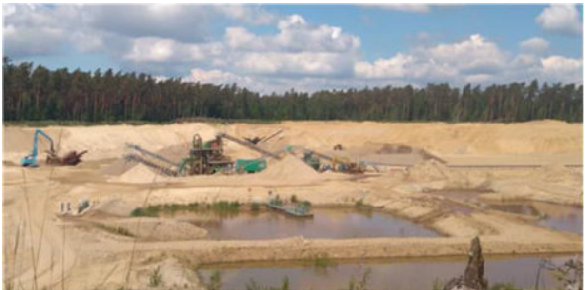
Abbildung 3: Aufbereitungsanlage zur Aufbereitung des Rohstoffes
